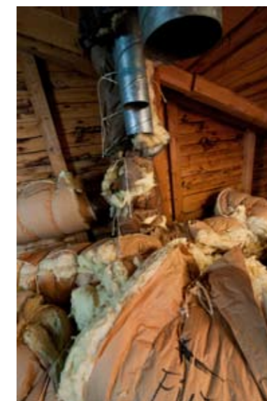
LÖSNINGEN Så här ser en del av det ventilationssystem ut, som ska hålla nere radonmängden i huset. Från vinden förgrenar sig en mängd tjocka rör neråt i huset via förråd och garderobser.
